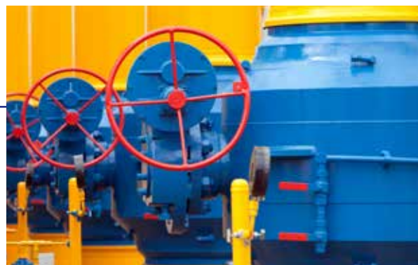
Interior y exterior de tanques y tubería para almacenamiento y transportes de diferentes líquidos.
