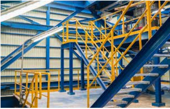
Pasamanos, escaleras en áreas en general en interior y exterior.
